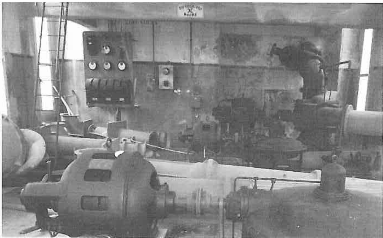
Idrovora di Luri. Elettropompe e organi di manovra
